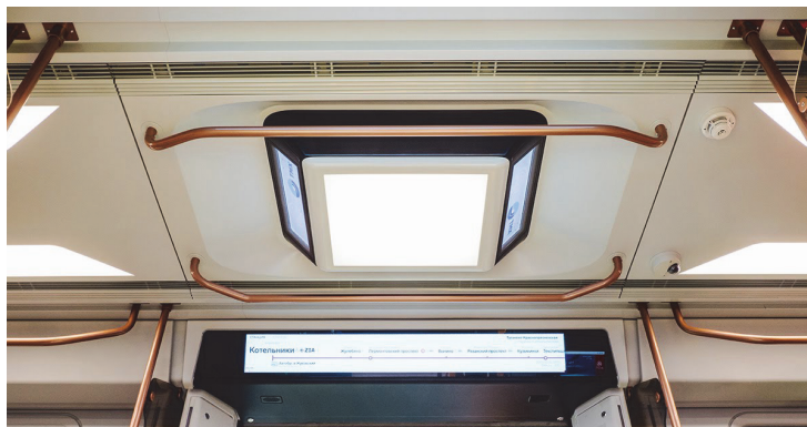
Рис. 2. Система кондиционирования, оборудованная ультрафиолетовыми лампами
